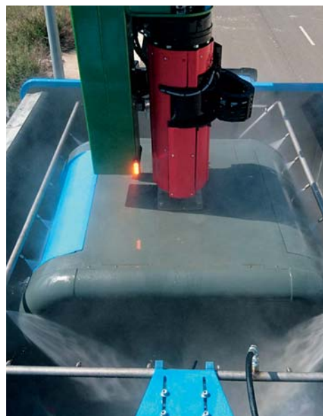
CONTENEDOR EN LA CÁMARA DE LAVADO
